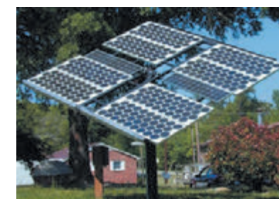
Fig. 23.3. Cristalele semiconductoare sunt folosite pentru confecționarea bateriilor solare
