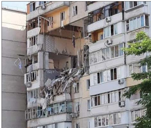
Des. 30. Urmările unei explozii de gaz
