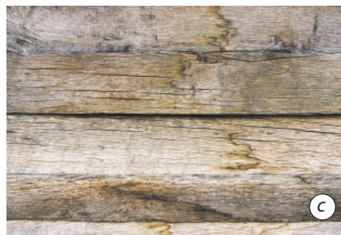
Rys. 4.9. Wady drewna: sęki (a), pęknięcia (b), grzybiczne zniszczenia (c)
