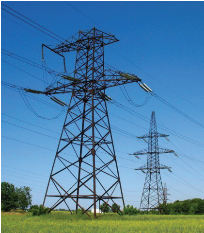
Stâlpii liniilor de înaltă tensiune
