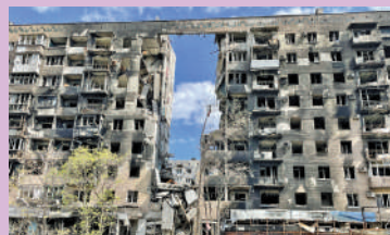
Загроза руйнування будівель
