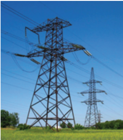
Опори ліній електропередачі
