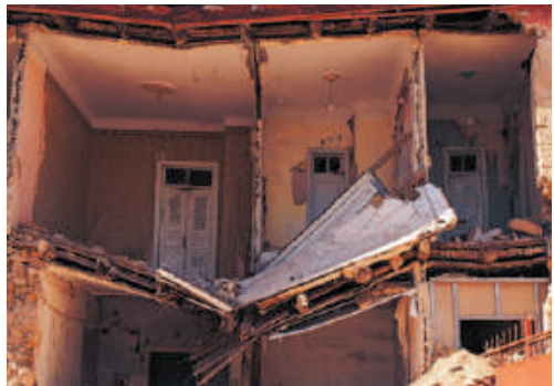
Мал. 26.1. Руйнівні наслідки землетрусу
