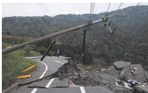
Rys. 40.6. Destrukcyjne skutki trzęsienia ziemi
